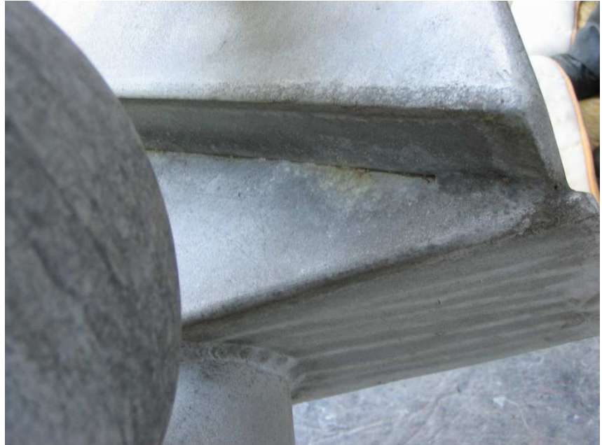
Spalt an der unteren Kante des Parallelepi-peds (1.2)
