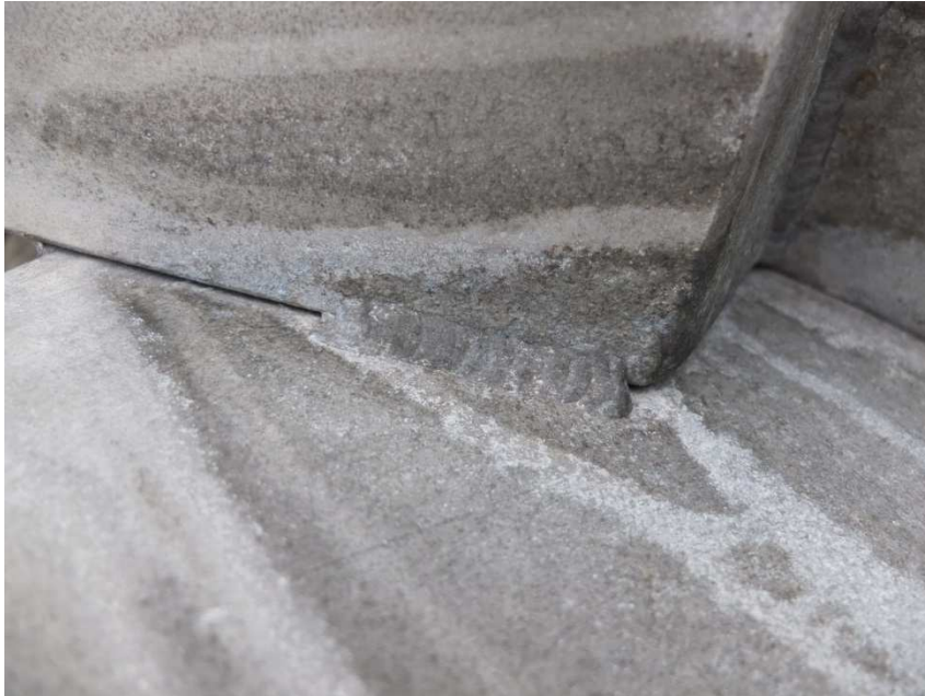
Verbindungsnaht an den geschweißten Blechkörpern mit sichtbaren Korrosionseinwirkungen (3.2)
