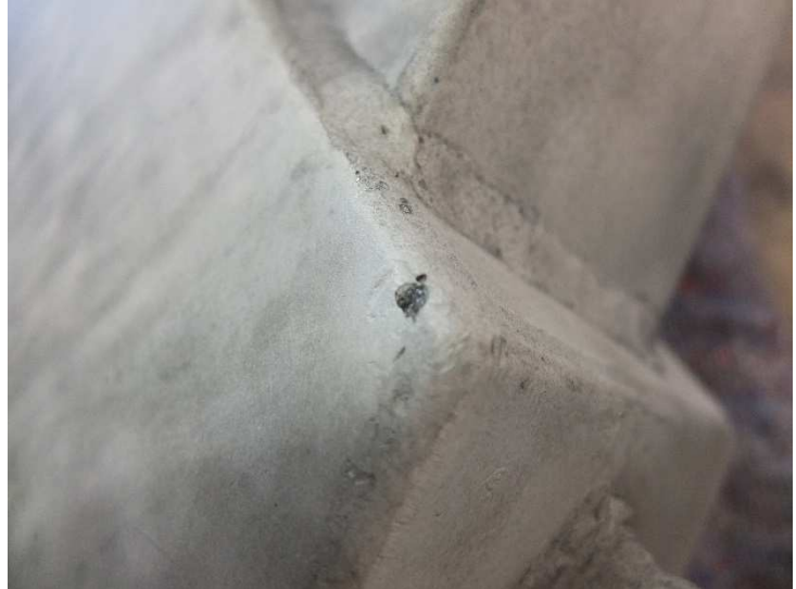
Lochfraßkorrosion an einer verschliffenen Schweißnaht (3.4)
